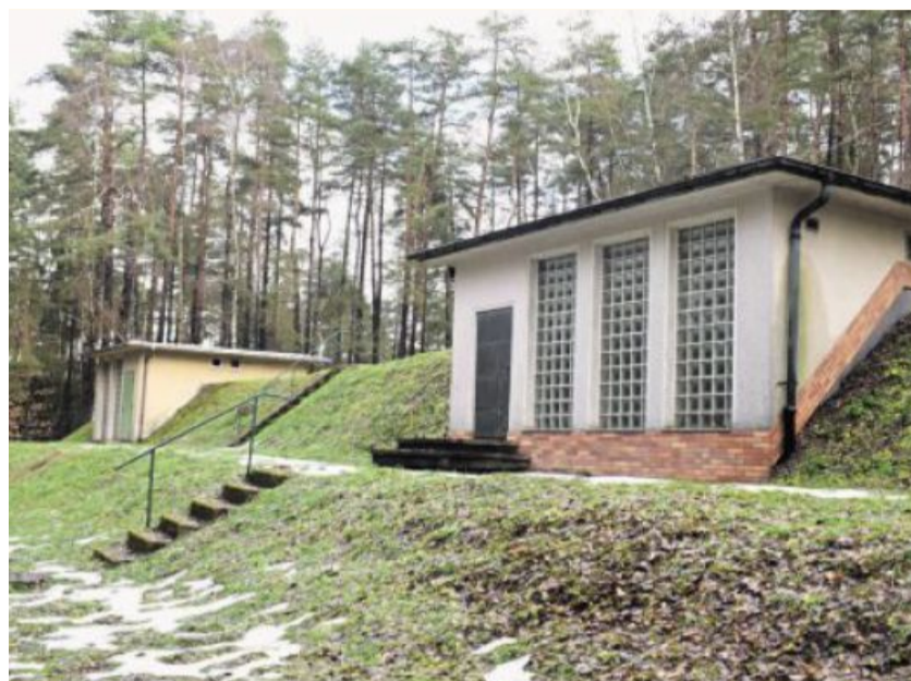
Die Sanierung des Hochbehälters II in Woppenhof ist eine der nächsten Aufgaben des Zweckverbandes Glaubendorfer Gruppe. Der Hochbehälter I (im Hintergrund) wird stillgelegt. Bild: bnr
