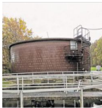
Die 40 Jahre alte Kläranlage ist deutlich erkennbar in die Jahre gekommen; die Gemeinde steht vor unaufschiebbaren Investitionen. Bild: List/exb
