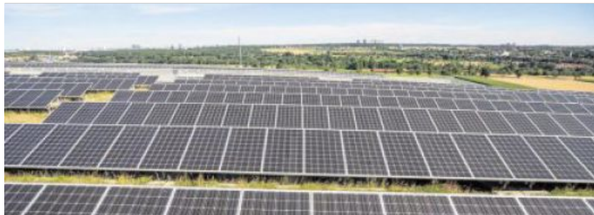
Der Marktgemeinderat Luhe-Wildenaue musste sich in seiner Sitzung mit der Errichtung einer Photovoltaikanlage auf einem Dach beschäftigen. Symbolbild: Christoph Schmidt/dpa
